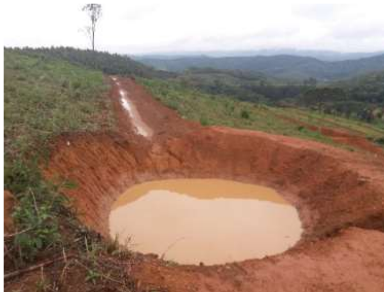
Figura 6 - Exemplo de bacia de contenção associada a terraço no projeto hidroambiental da UTE Rio Cipó (Fonte: INOVESA, 2020)
