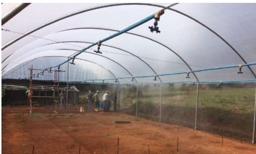
Figura 10 – Construção da estufa para produção de mudas no âmbito do Contrato nº 012/2018
