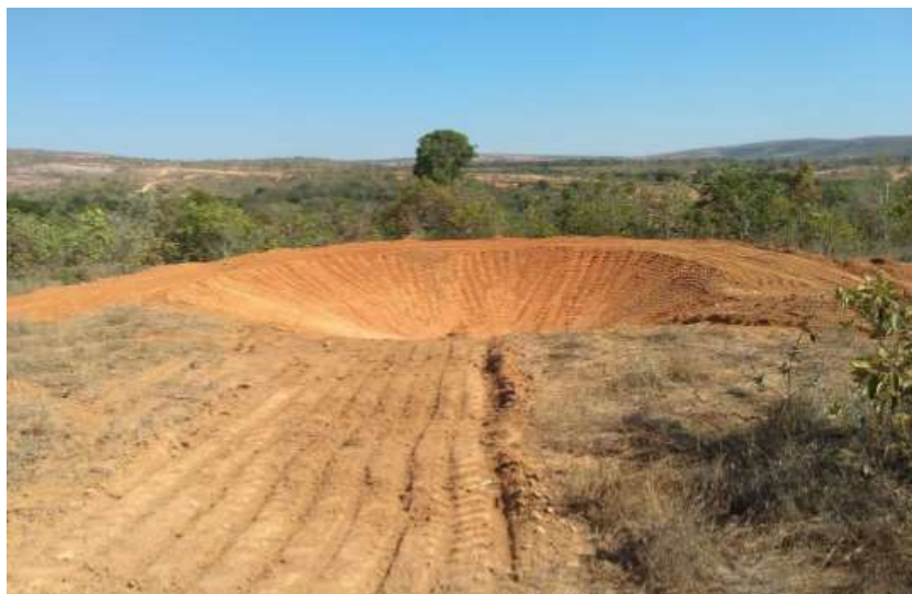
Figura 9 - Exemplo de bacia de contenção construída no projeto hidroambiental da UTE Bicudo.
