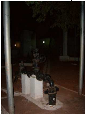
Figura 9.4. Poço N33. Sede da Copasa de Varzelândia.
