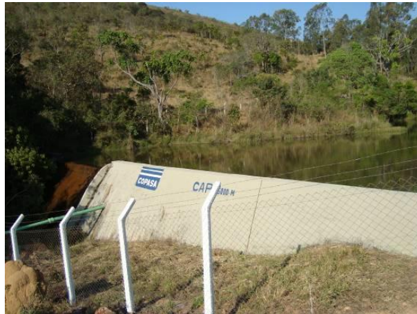
Figura 45 - Ponto de captação para o abastecimento doméstico e industrial da sede municipal de Ressaquinha.
