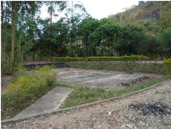
Figura 14 - Estação de tratamento de esgoto do distrito de Senhora das Dores (Barbacena).
