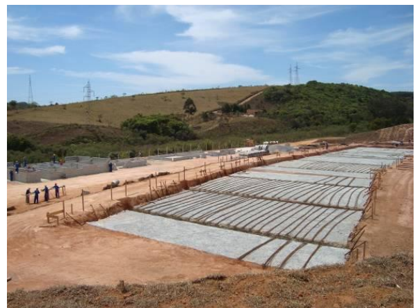
Figura 31 - Obras da estação de tratamento de efluentes da sede municipal de Barbacena.
