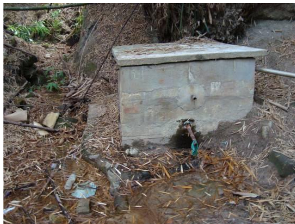
Figura 114 - Captação para o abastecimento doméstico do povoado rural Prainha (Ritápolis).
