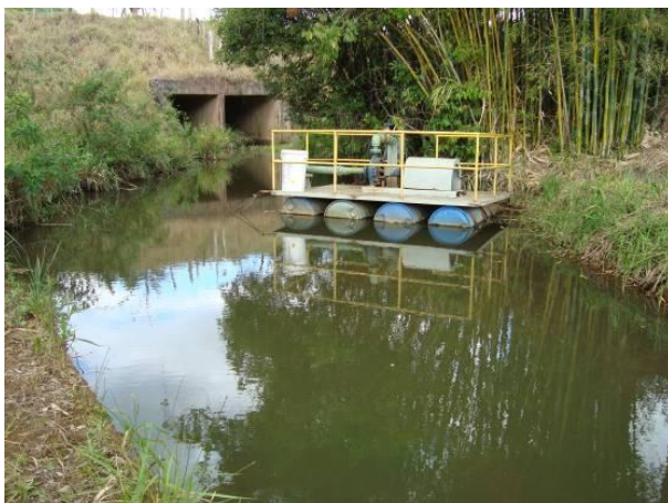
Figura 120 - Em destaque balsa de captação para abastecimento doméstico e industrial da sede municipal de Ritópolis.
