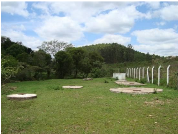
Figura 213 - Estação de tratamento de esgoto da sede municipal de Cana Verde.
