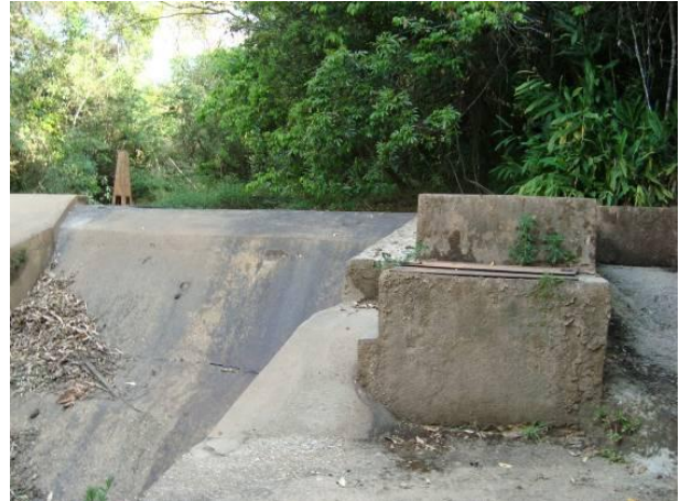
Figura 104 - Ponto de captação para o abastecimento doméstico e industrial da sede municipal de São João Del Rei, córrego Rio Acima.
