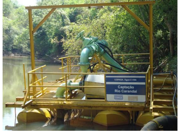
Figura 64 - Em destaque balsa de captação para o abastecimento doméstico e industrial de São João Del Rei e das localidades rurais de Cesar de Pina e Águas Santas ambas pertencentes a Tiradentes.
