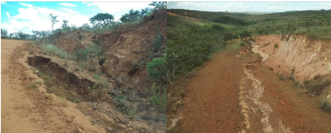
Figura 14.6 – Estradas rurais erodidas em Tiros/MG.
