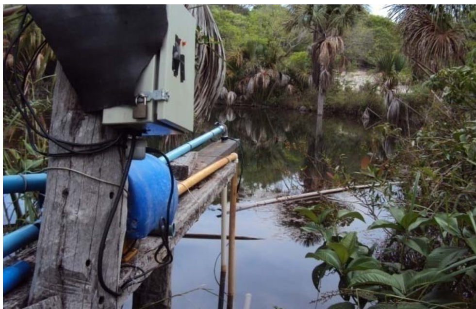
Figura 14.3 - Captação para abastecimento do distrito Vila Serrana.
