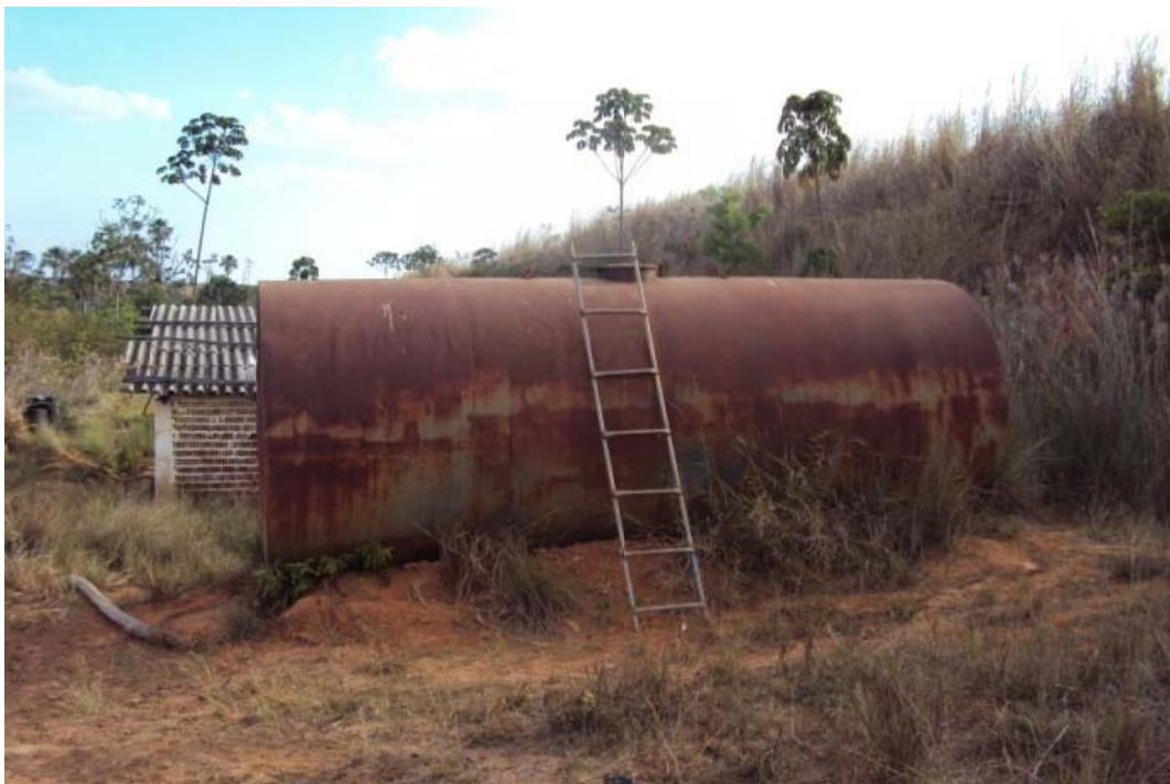
Figura 14.81 - Tanque de armazenamento de combustível (diesel) para os conjuntos moto-bombas. Fonte: Consórcio Ecoplan-Lume-Skill, 2011.
