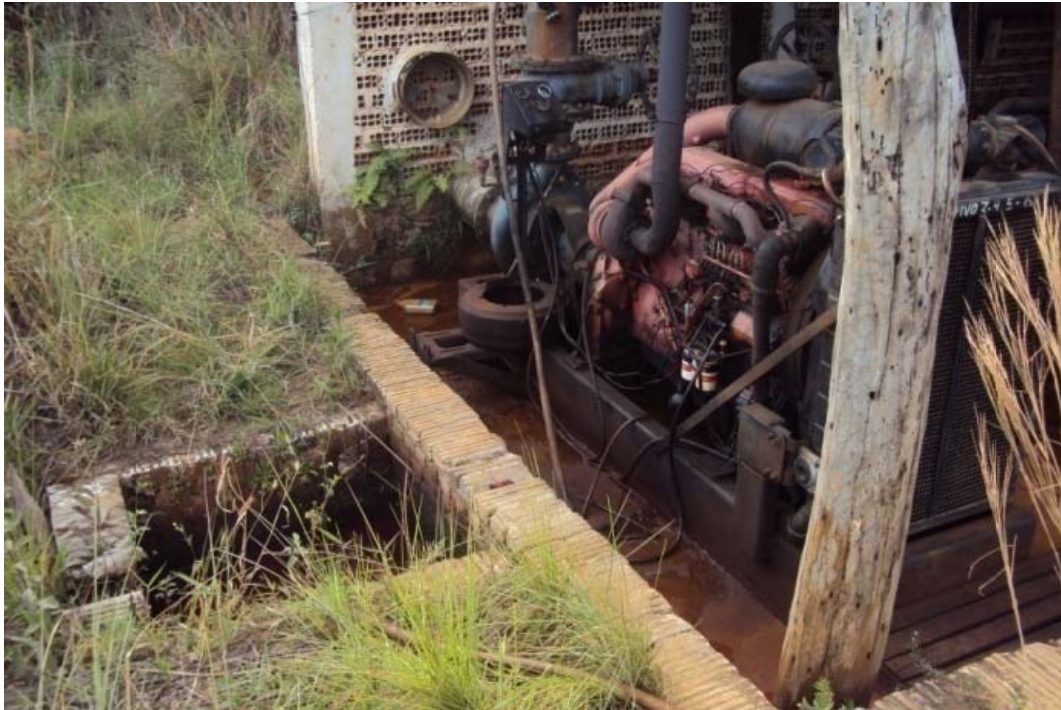
Figura 14.80 - Conjunto moto-bomba utilizado para captação do sistema de irrigação. Detalhe para os vazamentos de óleo, cujo direcionamento é dado para o solo. Fonte: Consórcio Ecoplan-Lume-Skill, 2011.
