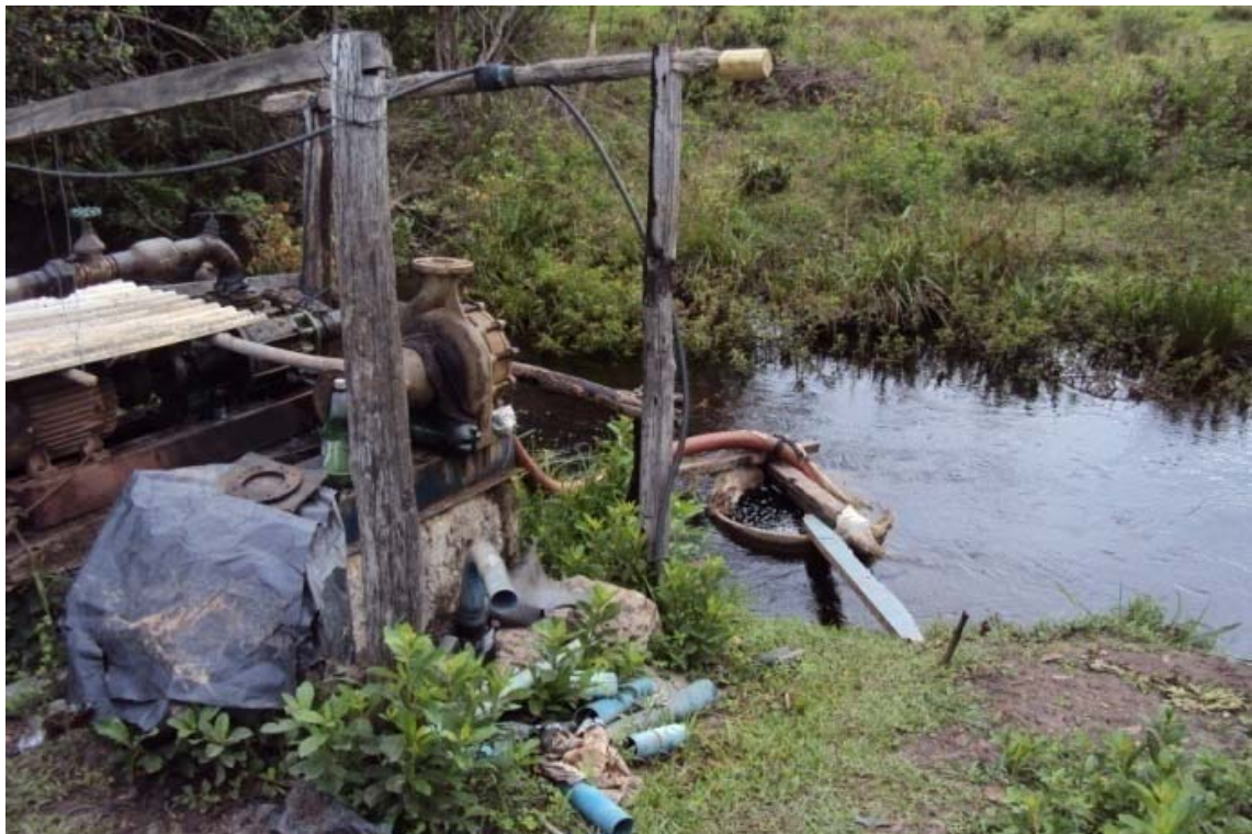
Figura 14.20 - Captção no córrego Jaboticaba para abastecimento do distrito São Joaquim em Januária. Destaque para a disposição inadequada de material. Fonte: Ecoplan-Lume-Skill, 2011
