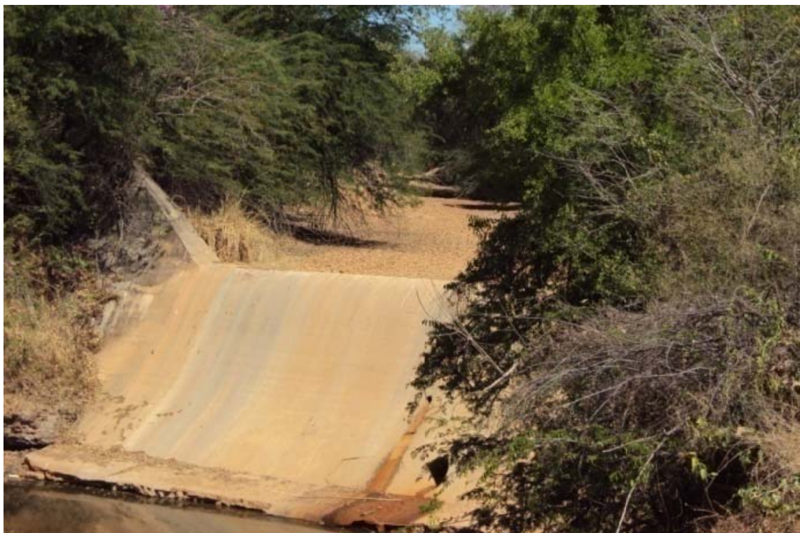
Figura 14.34 -Barramento de acumulação das águas e contenção de sedimentos. Detalhe para a quantidade de sedimentos retidos. Fonte: Ecoplan-Lume-Skill, 2011.
