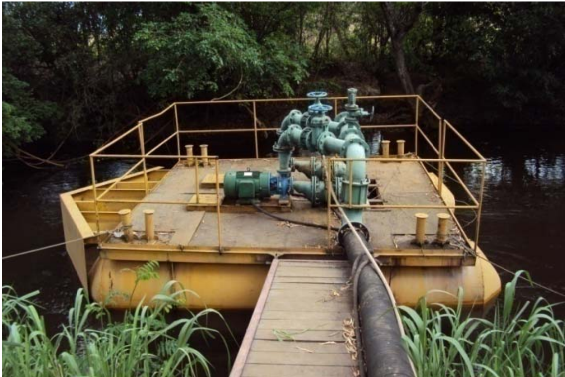
Figura 14.92 - Captação destinada ao abastecimento, após tratamento convencional, para a sede de Montalvânia. Fonte: Ecoplan-Lume-Skill, 2011.
