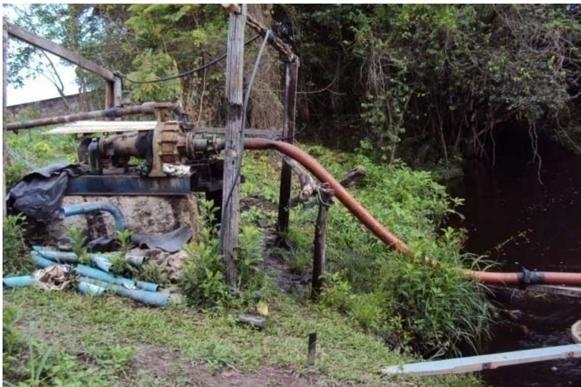
Figura 14.21 - Derrame de óleo da bomba da captação do distrito São Joaquim, às margens do córrego Jaboticaba. Fonte: Ecoplan-Lume-Skill, 2011
