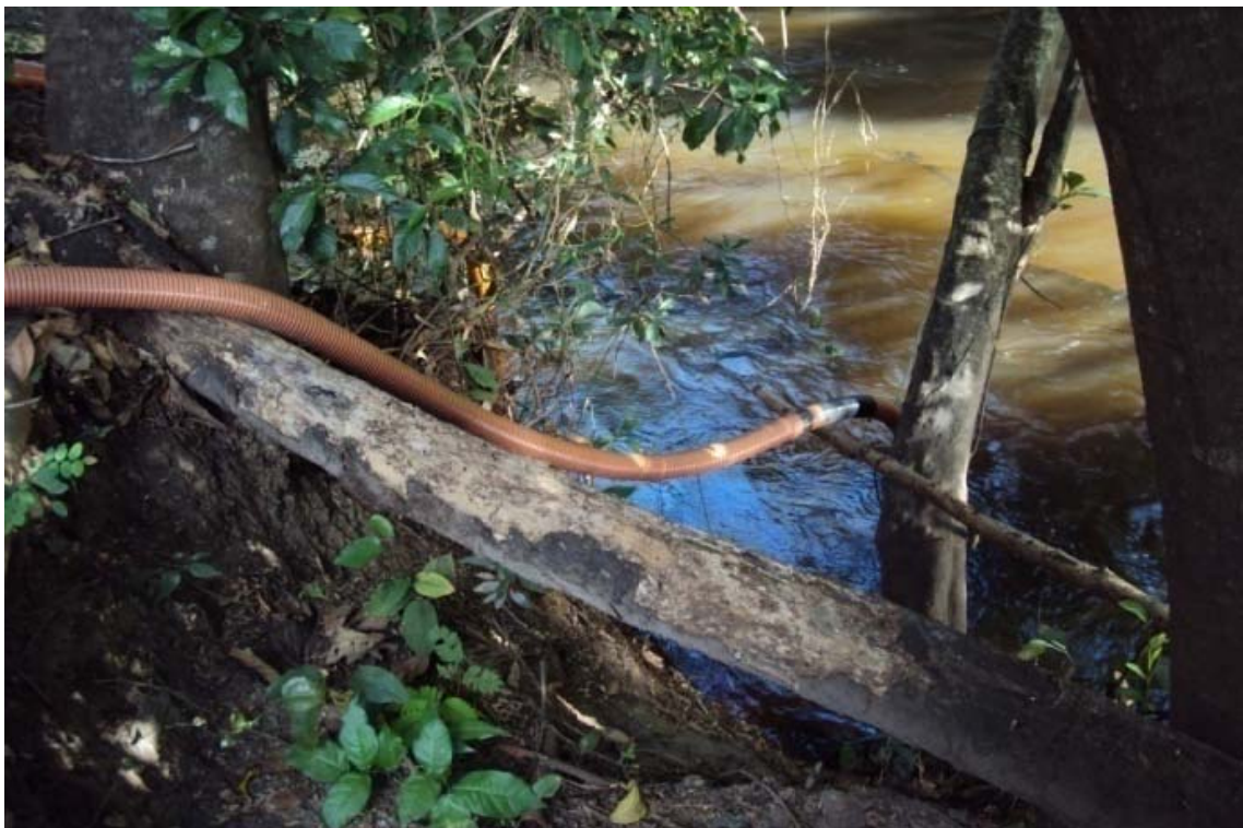
Figura 14.91 - Captação destinada ao abastecimento, sem tratamento, para a localidade de Mateira. Fonte: Ecoplan-Lume-Skill, 2011.
