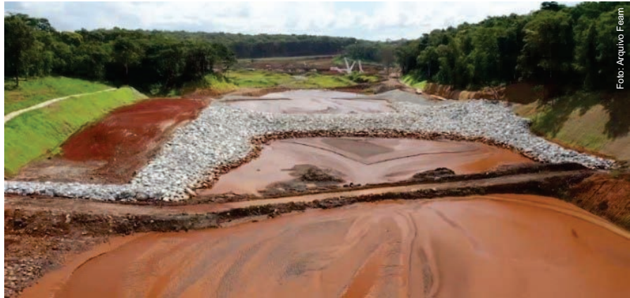
Barreira Hidráulica Filtrante 0 (BH0)
